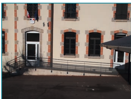
Fabrication et pose d'une rambarde de sécurité pour l'accès à l'école du haut
